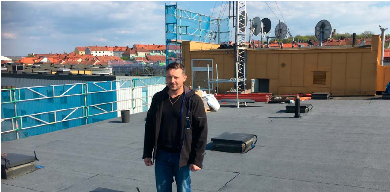
Daniel Lindgren, tekniskt ansvarig på förvaltningen, går också upp på taken och kollar ibland. Här på loftgångshuset på Vaktmästaregång 16, där man passar på att ta ner antenner för kabel-tv som inte längre är i drift. Här uppe finns också en av de väderstationer som styr värme och ventilation.
