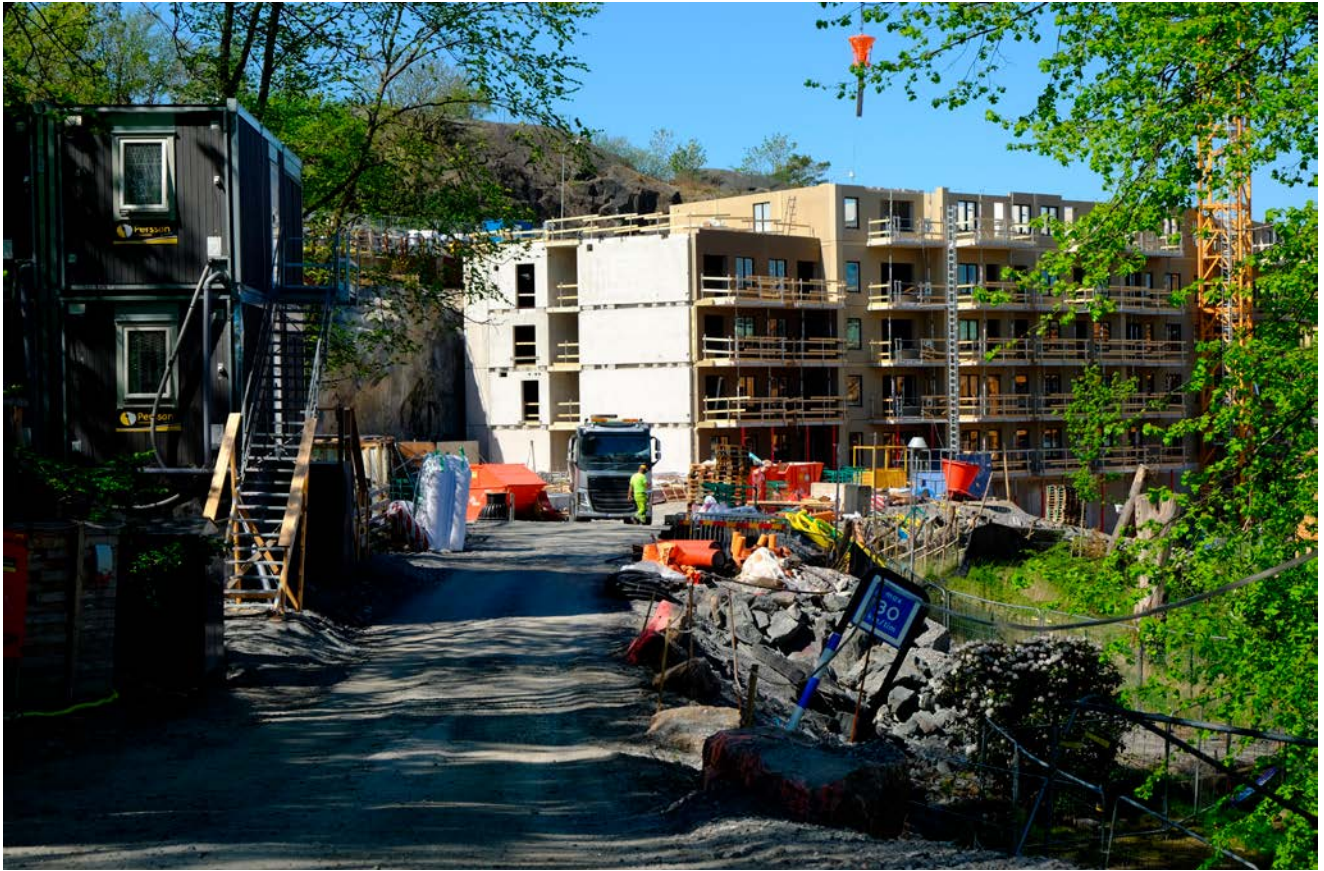
Mycket berg har sprängts bort för att få plats med de nya husen på Kjellmansgatan.
