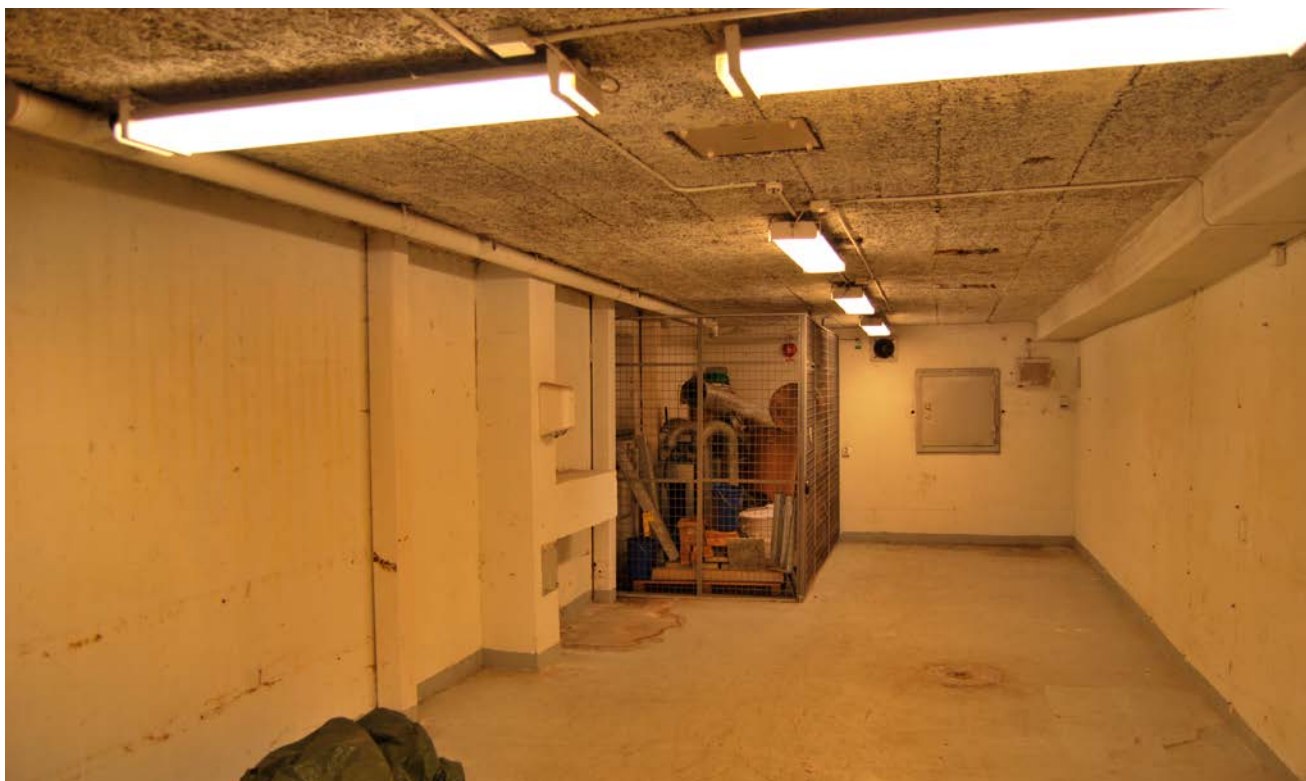
I buren i skyddsrummet på Kjellmansgatan finns allt som behövs. Ventilationsutrustning, toalett och beskrivning för att ordna allt.
