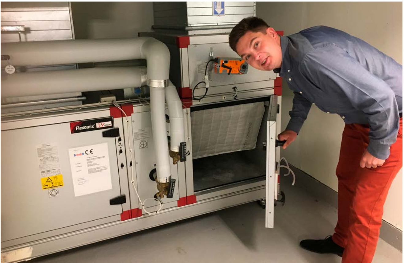
Tilluftsaggregatets luftfilter ser till att alla boende får ren luft in i lägenheten. De byts minst en gång per år.
