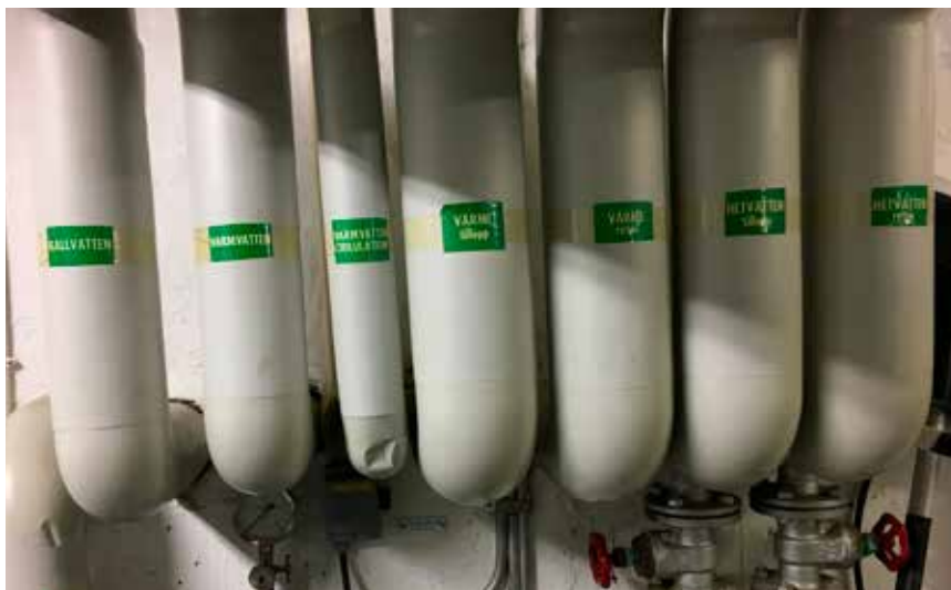
De olika ledningarna i undercentralen är väl uppmärksamma.
