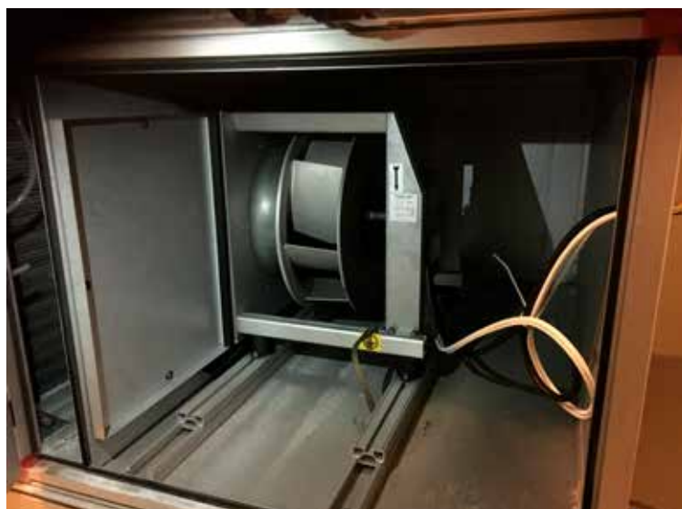
En ny direkt driven fläktmotor sparar mycket energi jämfört med de äldre modellerna. Fläktarna sitter i separata fläktrum.
