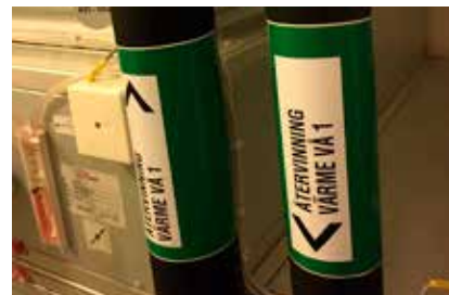
Där det är möjligt installeras värmeväxlare som tar vara på värmen i den frånluft som lämnar lägenheterna via ventilationssystemet. På detta sätt används denna värme till att förvärma den luft som ska blåsas in i lägenheterna.
