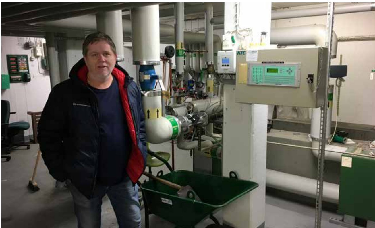
Brf Masthuggets drifttekniskt ansvarige Magnus Kööl i undercentralen på Klamparegatan 9, som servar båda husen på Klamparegatan. I undercentralen sitter en dataundercentral (DUC) som styr värmen till lägenheterna, varmvattnet till kranarna samt till- och frånluftsventilationen i husen. Allt detta kan Magnus styra från sin dator på kontoret, men ibland behöver han titta till undercentralerna. I hela föreningen finns 15 undercentraler.
