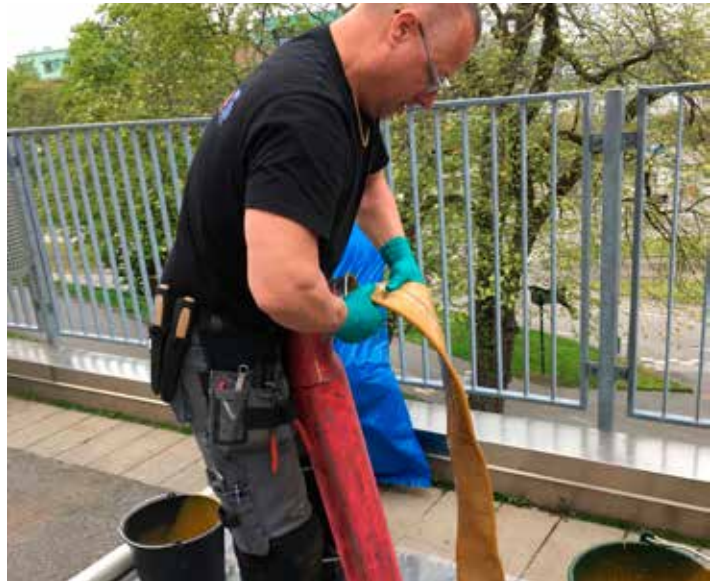
Strumpan packas in i den så kallade kanonen, ett plåtrör från vilket strumpan skjuts in i avloppsröret och vrängs ut och in så att den glatta gula sidan hamnar ut mot själva avloppsvattnet, medan den andra sidan ska fästa mot det gamla järnröret.
