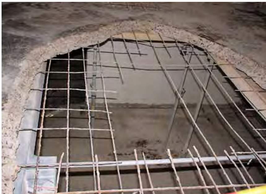
Skadorna på betong och armeringsjärn var stora i första etappen i Fjällgatas garage. Bilden visar den största skadan, där skadad betong och sönderrostade armeringsjärn tagits bort.
