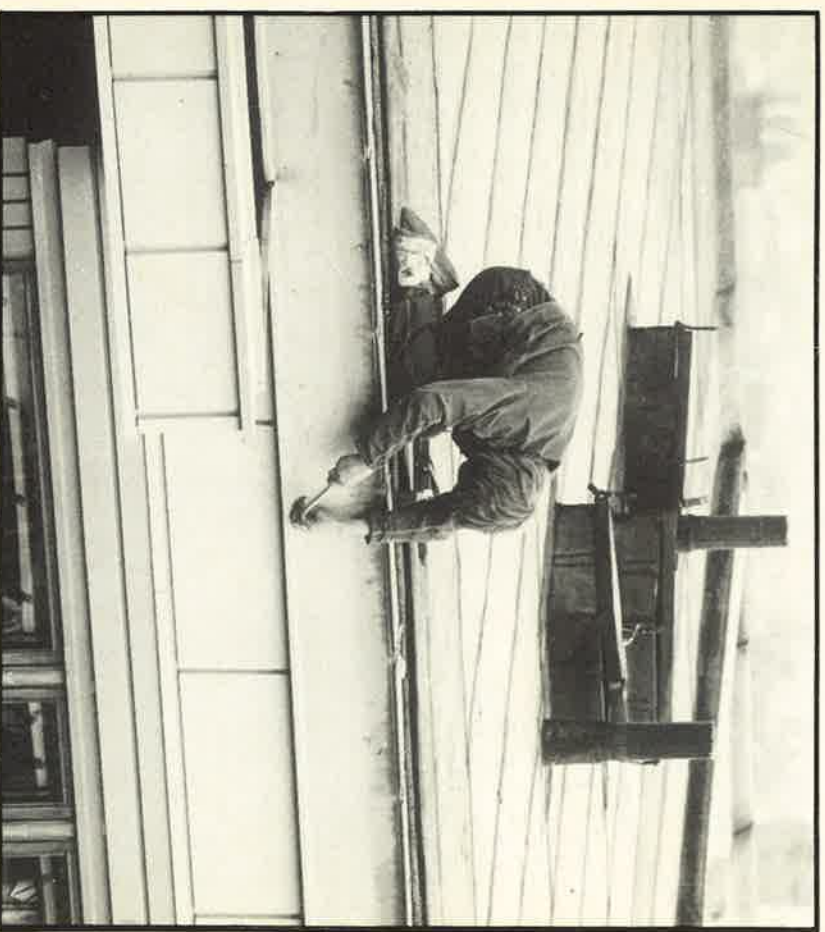
En ung plåstlagare med kroppen till hälften över avgrunden, utan säkerhetslina. Men om taktäckaren WICOTE i fortsättningen inte jobbar under byggande former kommer de att polisanmälas.
